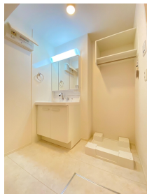
洗髪洗面化粧台、室内洗濯機置場
